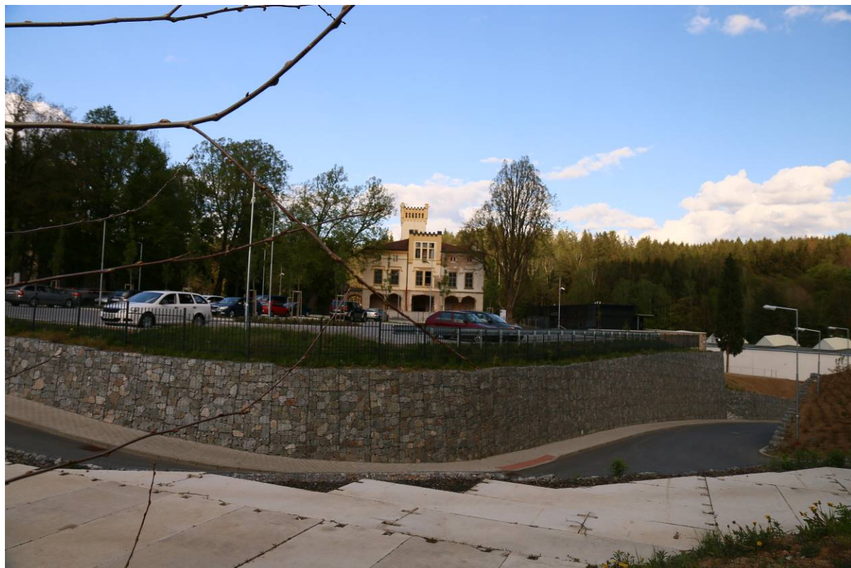
Foto č.3 – nová komunikace a černá stavba parkoviště - 10.5.2019
